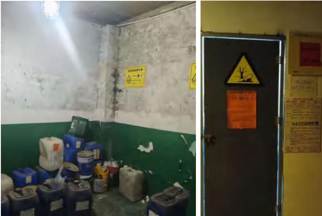
图 4-1 危险废物仓库
