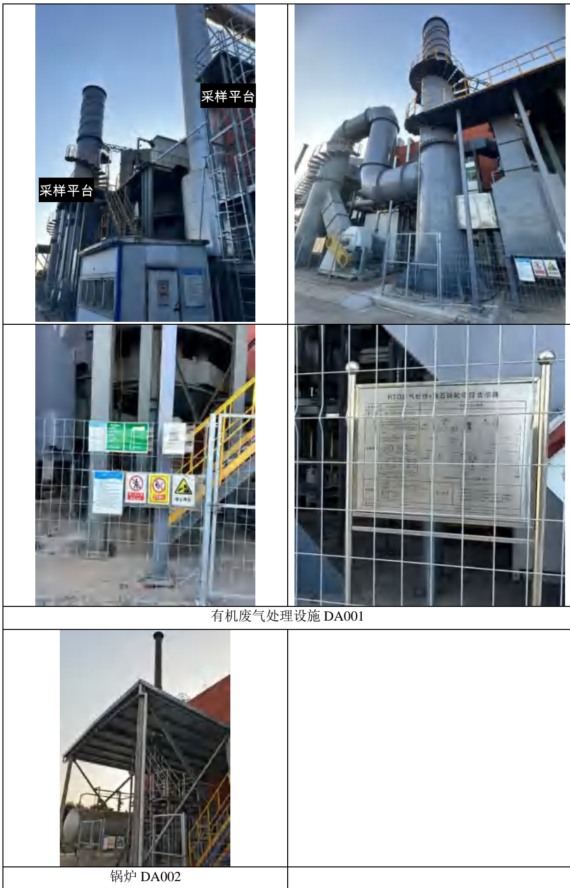
图4-2 废气治理设施照片
