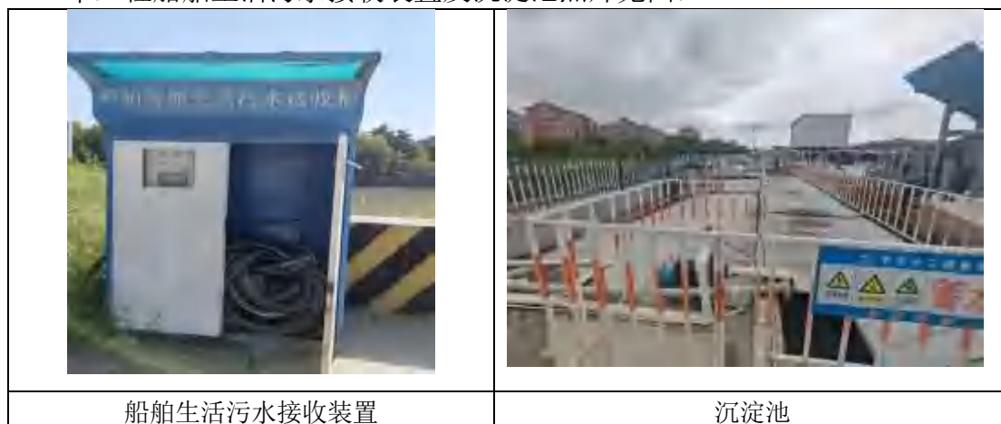
图7-1 废水处理设施图
