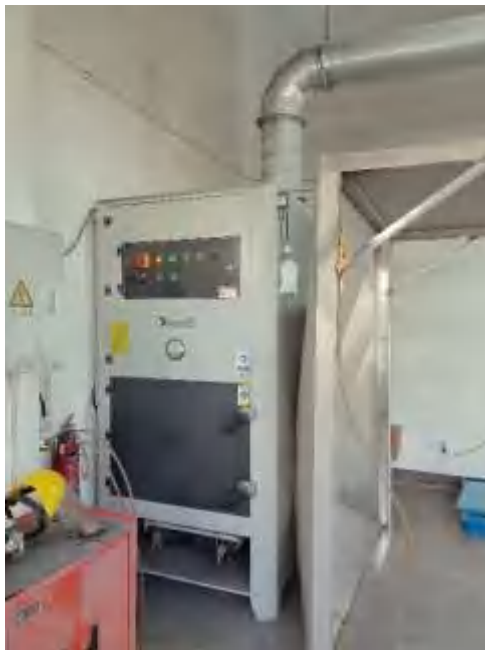
图 4-2 本项目打磨废气设施图片
