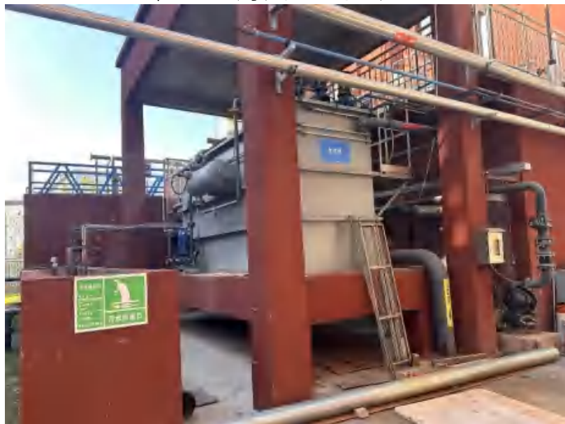
图 4-2 废水治理设施照片
