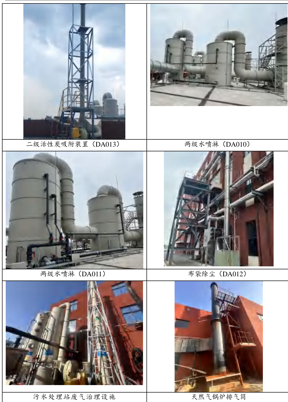
图4-4废气治理设施照片
