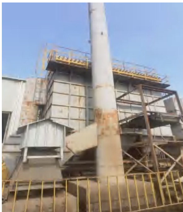
图 4-1 废气治理设施照片
