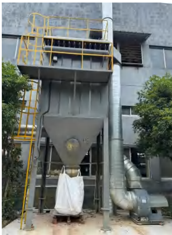
图 4-5 本项目车加工粉尘处理设施
