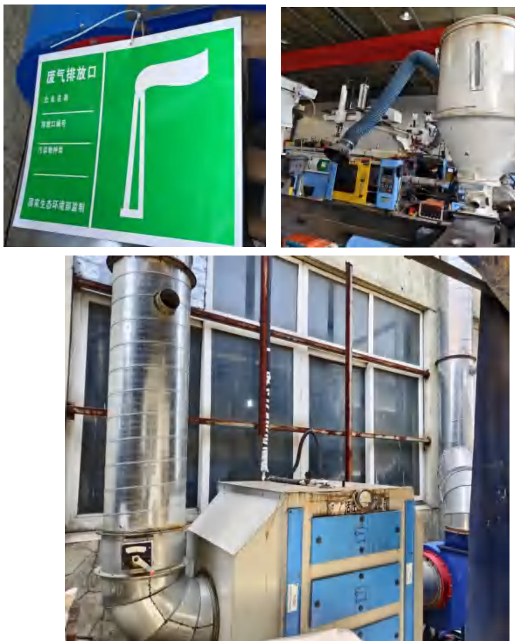
图 4-2 本项目主要废气治理设施
