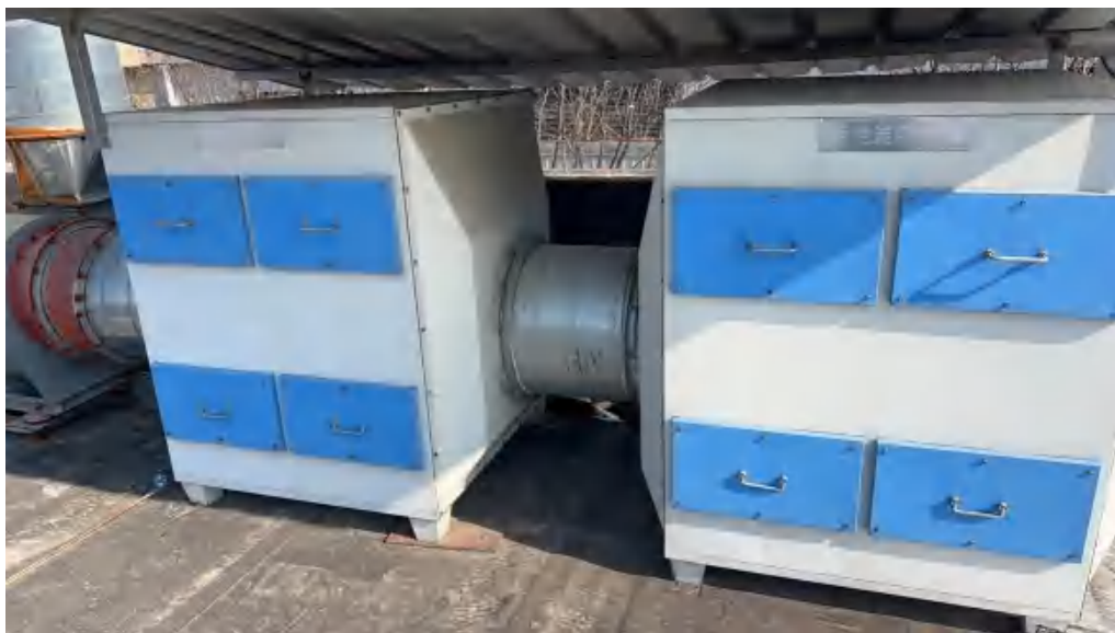
图 4-2 本项目注塑废气处理设施
