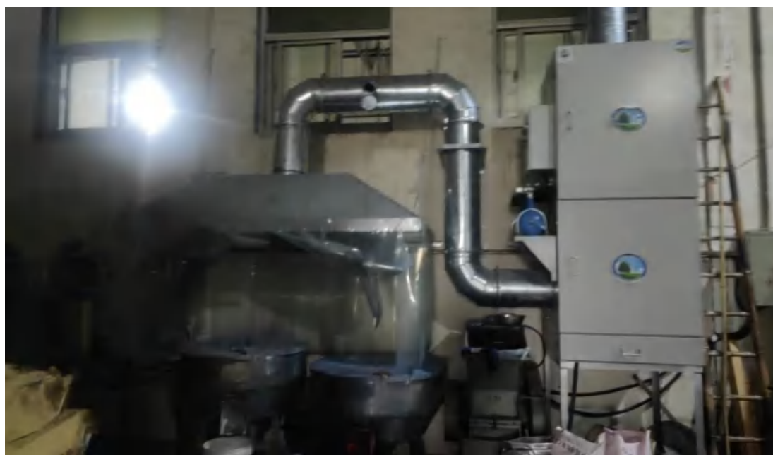
图 4-3 本项目拌料、投料废气处理设施
