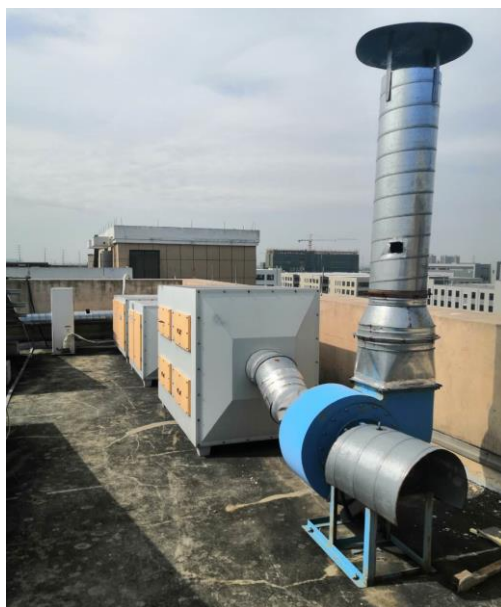
图 4-2 本项目油漆废气处理设施图
